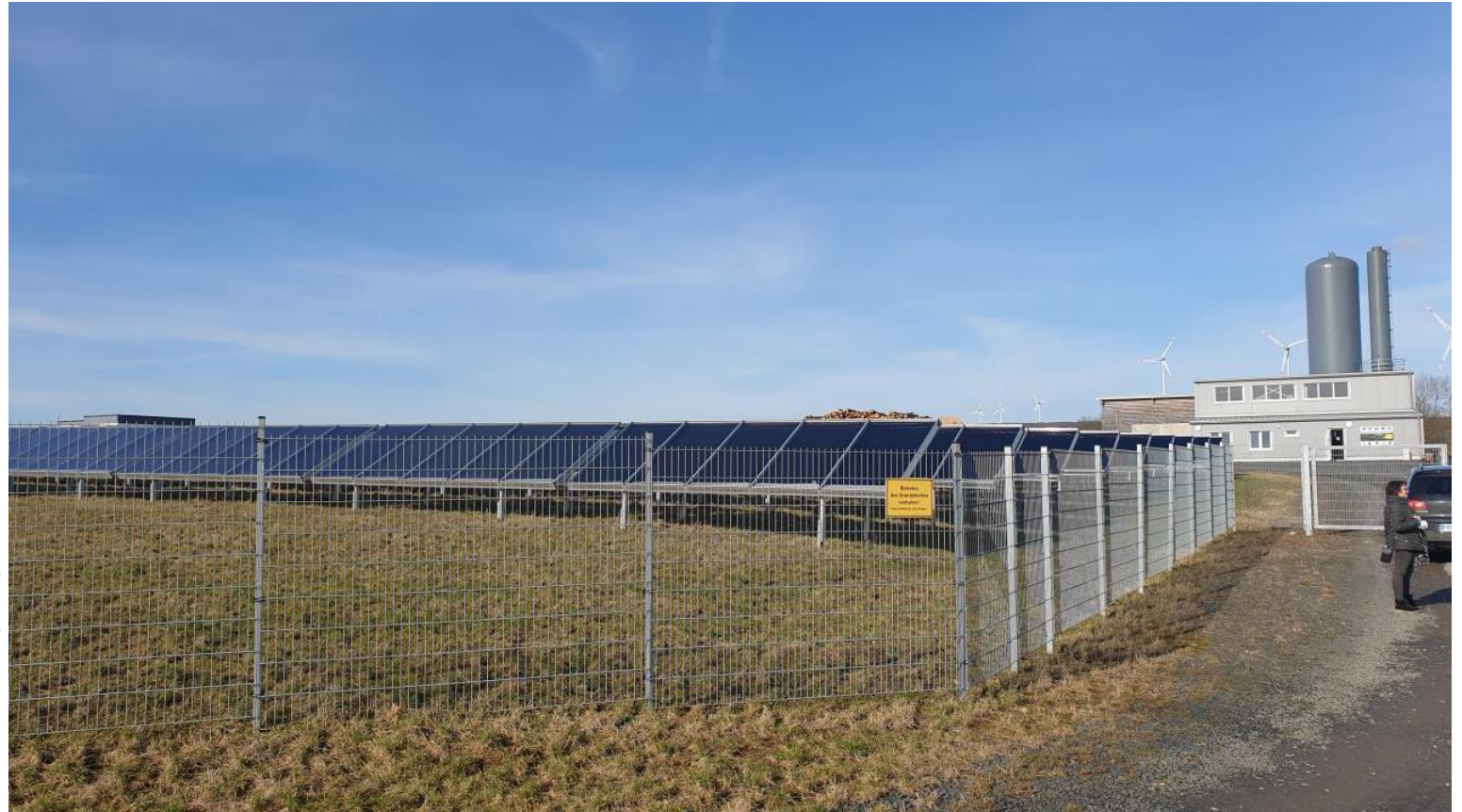
Nahwärme Mengsberg, Foto AK Solarwärme Bracht
