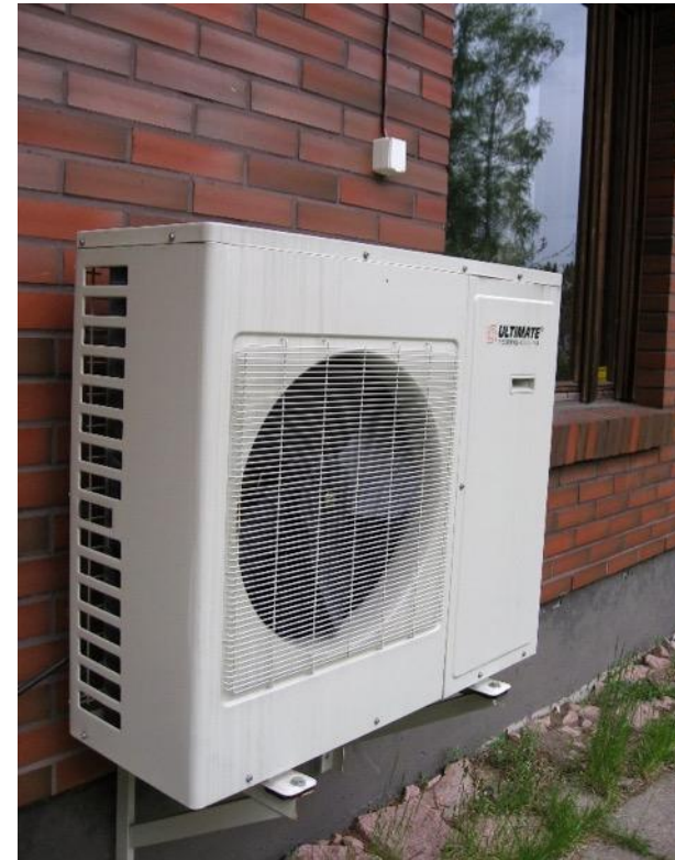
Außeneinheit einer Luft-Wasser-Wärmepumpe
